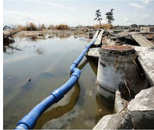
Pic4. PE pipeline example (2)
