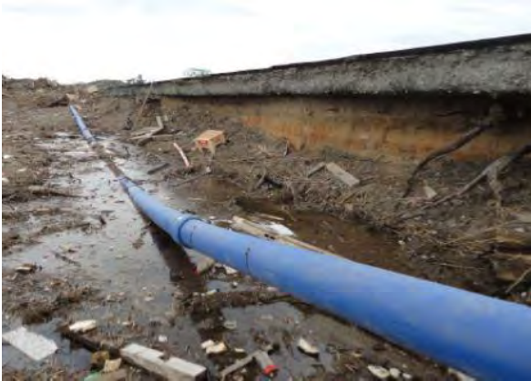
Pic3. PE pipeline example (1)
